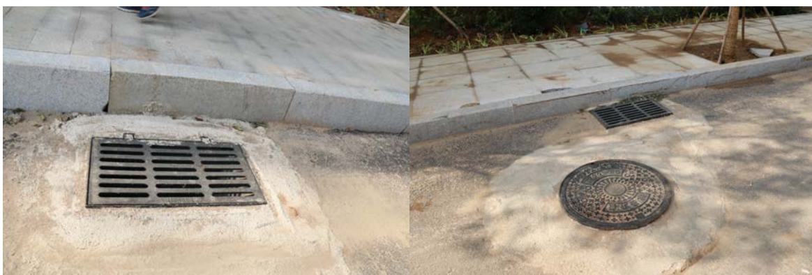
车辆段与综合基地地区排水设施
